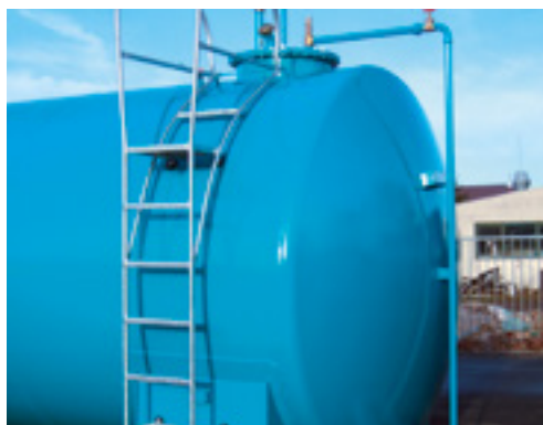
Dieseltank mit Podest und Saugleitung
